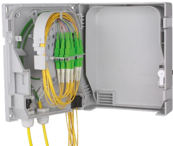
Eine typische HÜP-Box mit installierten Glasfaserleitungen
